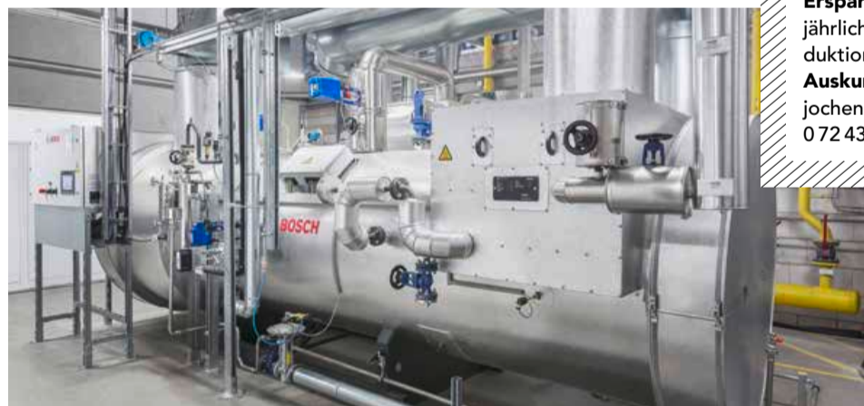
Der Abhitzekeessel liefert Dampf in der Grundlast
